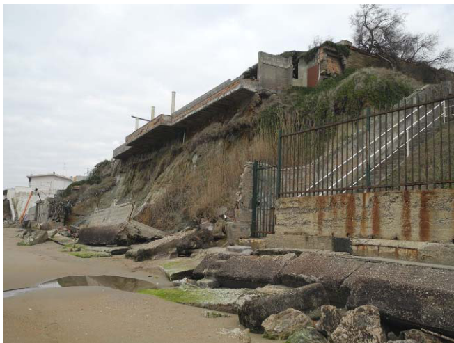
Foto 1 – Loc. Lido di Anzio Colonia - Frana per scivolamento e crollo di strutture per effetto dell'erosione marina
