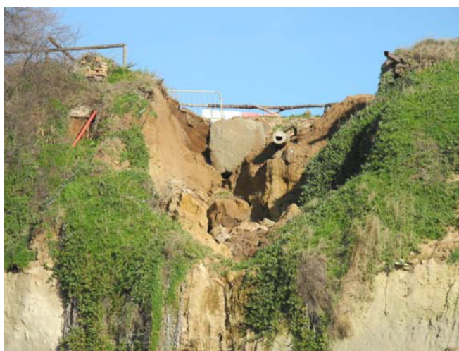
Foto 3 – Anzio, loc. Villa di Nerone (a valle della Caserma) - Fenomeni di disordine idraulico: erosione accentuata al tetto della falesia per effetto delle acque dilavanti concentrate
